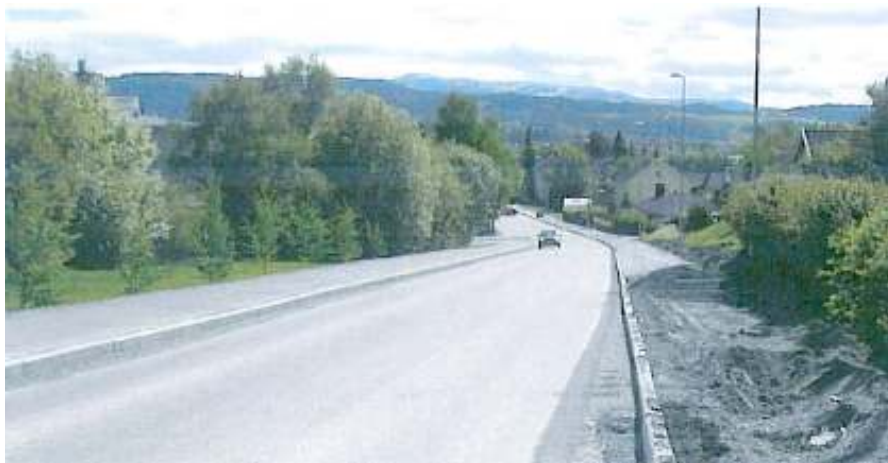
Fv. 173, Nordgata – Verdalsøra barneskole/ungdomsskole. Her bygges nå(2006) fortau på begge sider av vegen.
