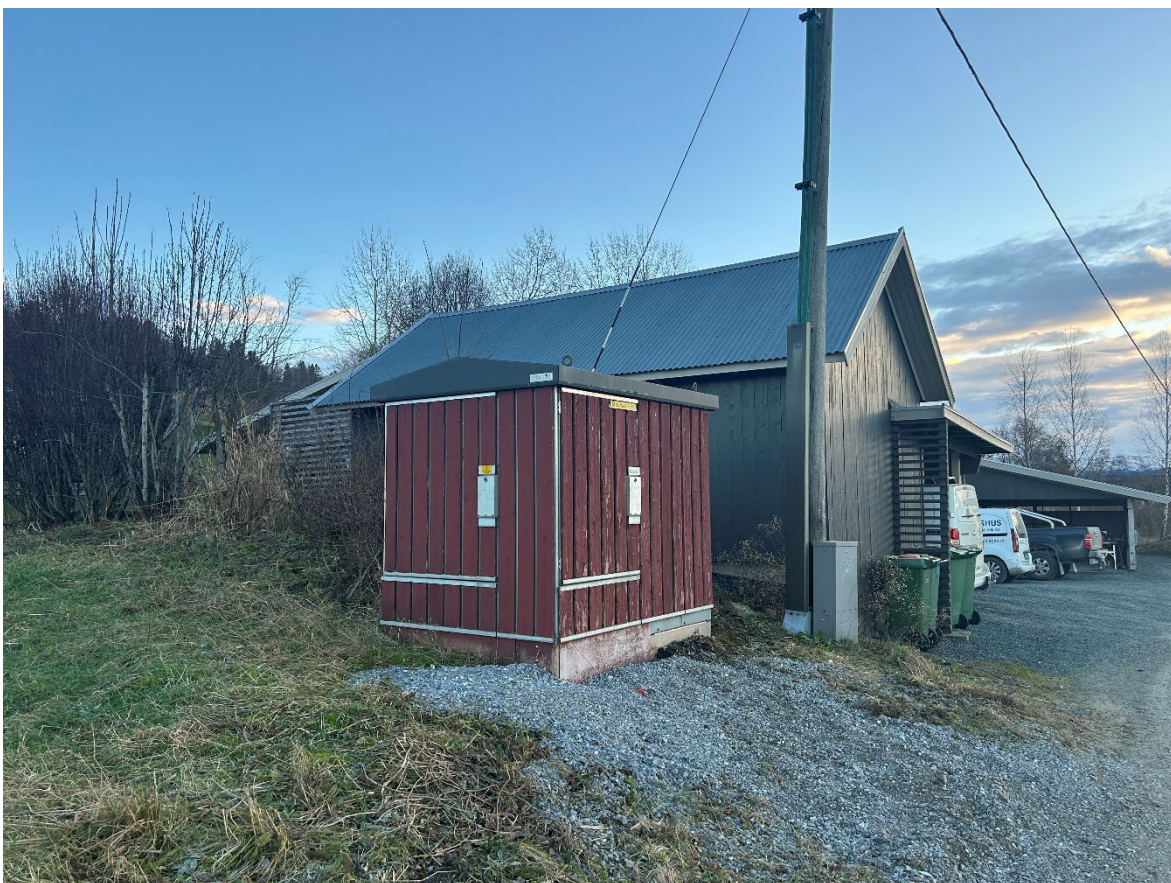
Figur 11 Eksisterende trafostasjon (Kilde: Norgeshus AS).
