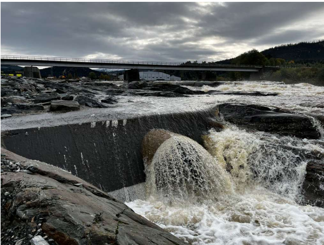
Figur 42: Utløp ny kulvert Ekerbekken, endekloss, ved stor vannføring
