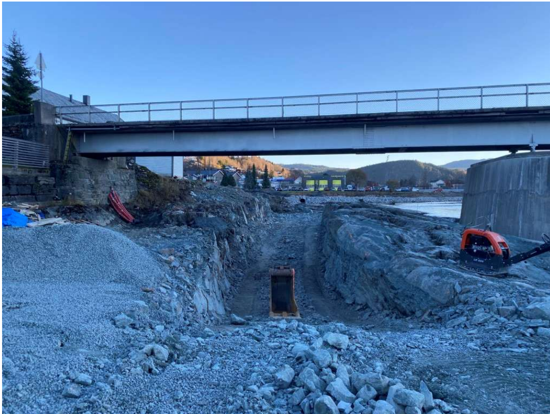
Figur 39: Utsprengt kanal under fylkeskommunal bru. Ny kappestøp på brukaret til høyre.
