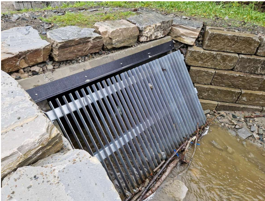
Figur 48: Rist foran kulvertinnløp Ekerbekken
