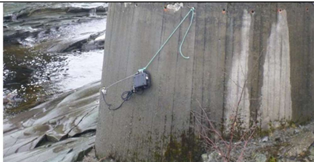
Figur 3-1 Rystelsesmåler på kappestøp brufundament
