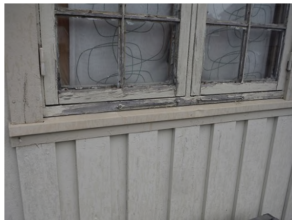
Figur 11: Svært gamle vinduer i bygg B
