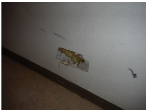
Figur 14: Stedvis stor innvendig slitasje bygg C
