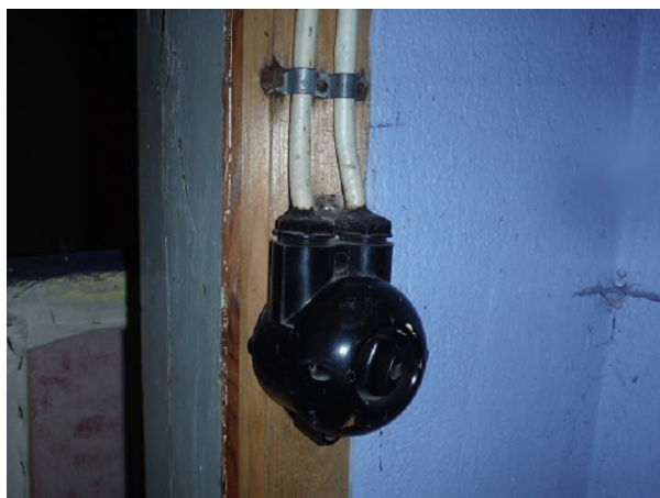
Figur 30: En del gammel el-installasjon i bygg A
