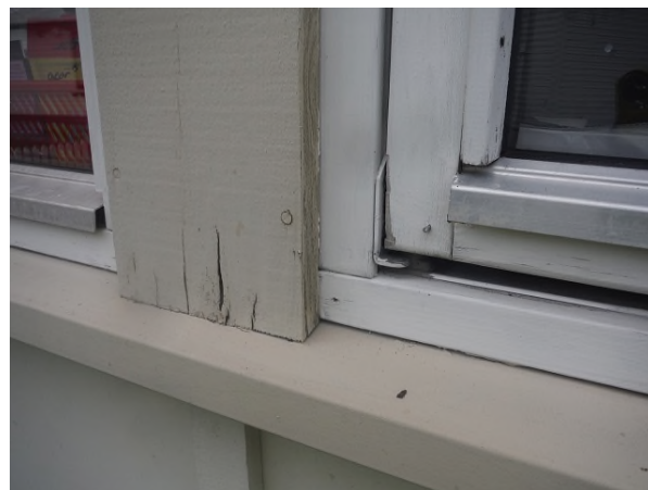
Figur 13: Utvendig vedlikeholdsbehov bygg C
