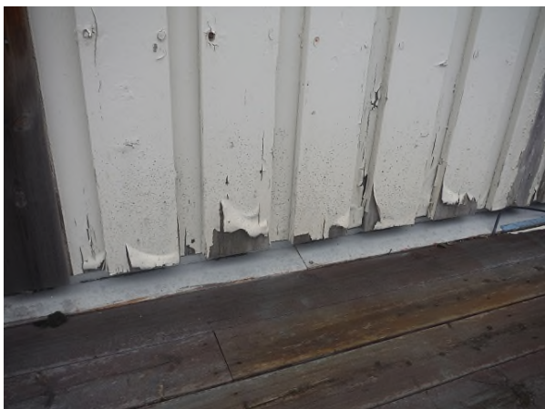
Figur 8: Stort behov vedlikehold fasader bygg A
