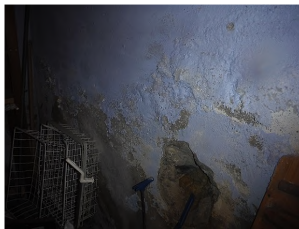
Figur 7: Utfelling kjellervegger, svikt drenering
