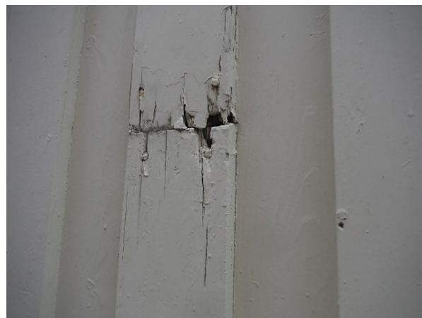
Figur 10: Råte i utvendig kledning bygg B
