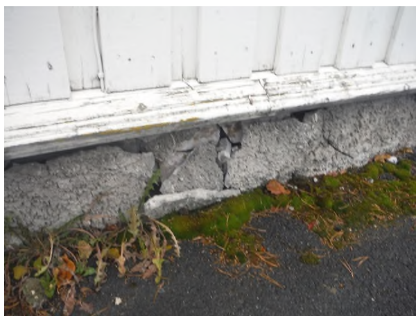
Figur 6: Store sprekker i grunnmur bygg A
