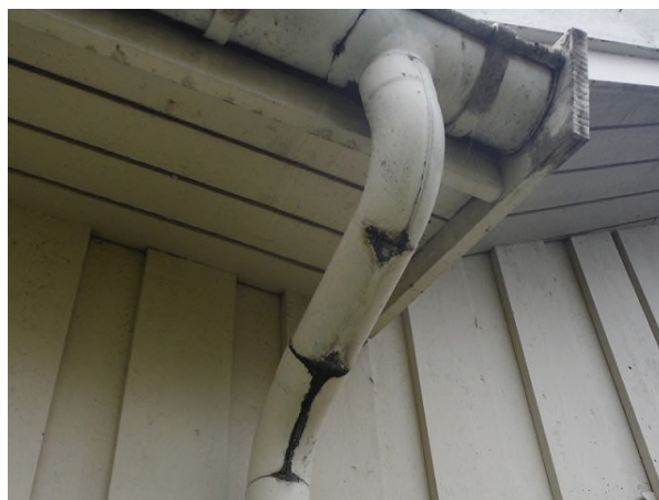
Figur 20: Takrenner bygg C må skiftes
