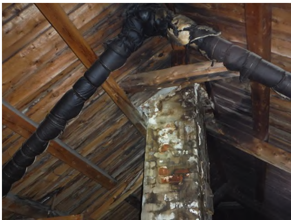
Figur 19: Omfattende behov tak, bygg A
