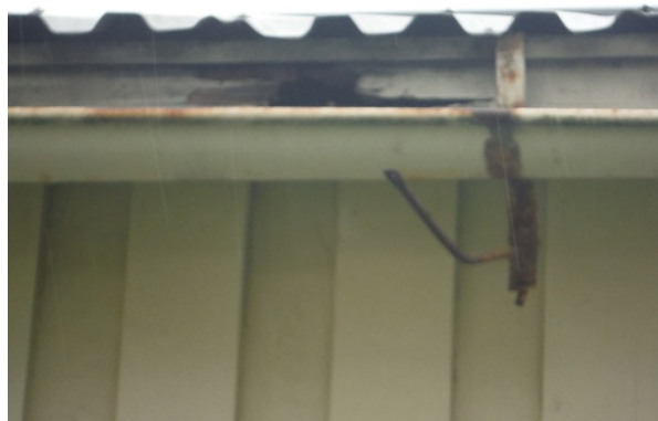
Figur 21: Råteskader, ødelagte takrenner, bygg B
