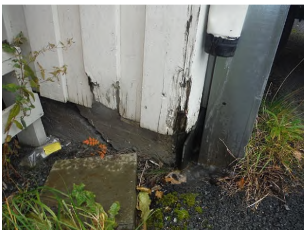
Figur 9: Råteskader pga dårlig løsning taknedløp
