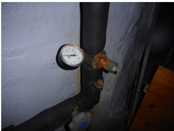
Figur 28: Gamle vannrør/komponenter i bygg A
