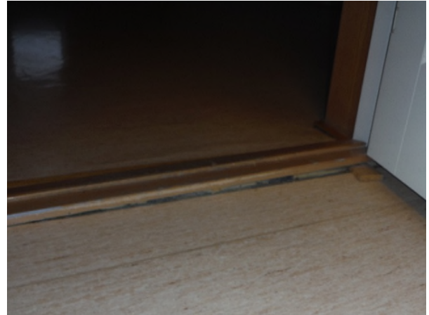
Figur 24: Svært skjeve gulv, svikt/knirk, bygg A
