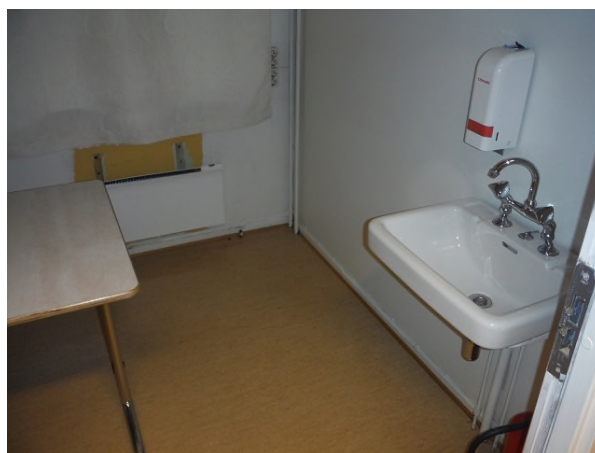
Figur 16: Behov totalrenovering wc, kjøkken o.a
