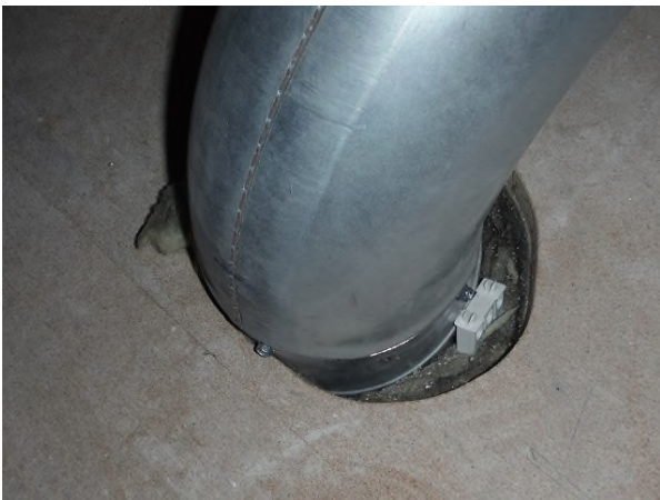
Figur 23: Avvik fra brannkrav teknisk rom
