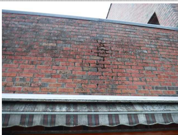
Bilde nr. 235-05 Groing på fasader gir fuktskader
