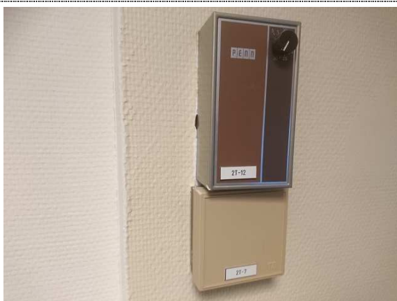
Bilde nr. 563-01 Utdatert automatikk
