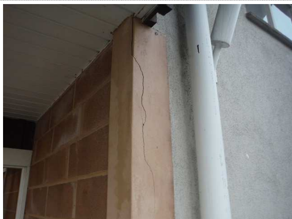
Bilde nr. 235-01 Sprekker i utvendig puss
