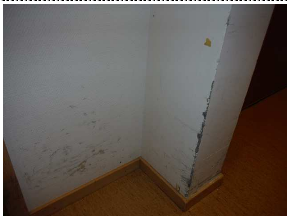
Bilde nr. 246-02 Vedlikeholdsbehov strietapet
