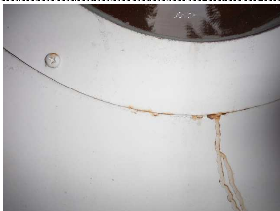
Bilde nr. 234-05 Korrosjon ytterdører i stål
