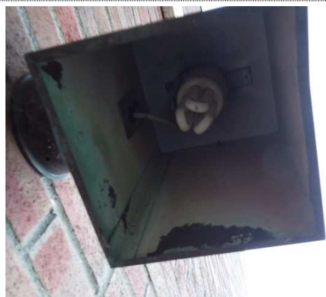
Bilde nr. 442-03 Utvendige lysarmaturer utslitt
