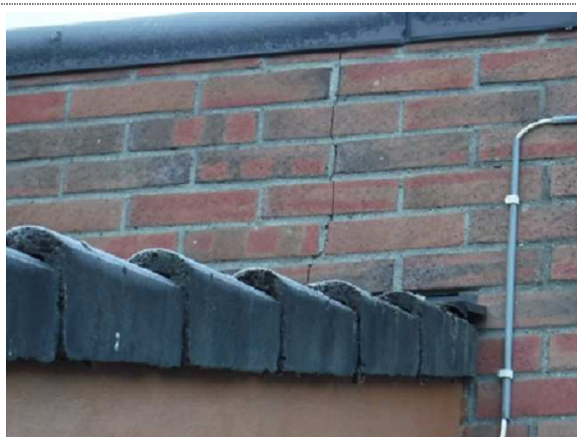
Bilde nr. 235-07 Sprekker i tegl parapet/fasade
