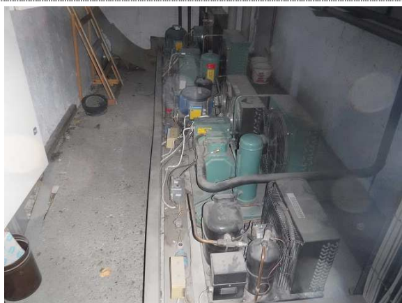
Bilde nr. 351-01 Gamle kjølekompressorer
