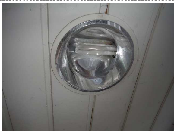
Bilde nr. 442-02 Sprø sokler/ledninger i lysarmaturer
