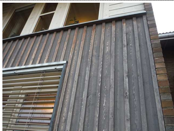
Bilde nr. 235-06 Vedlikeholdsbehov utvendig lektepanel
