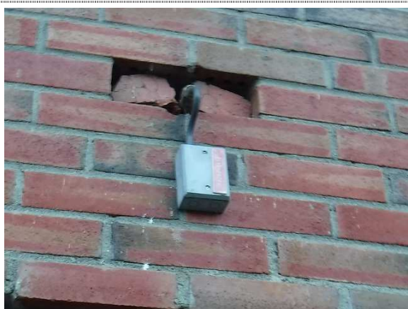
Bilde nr. 235-09 Løse/ødelagte enkeltstein
