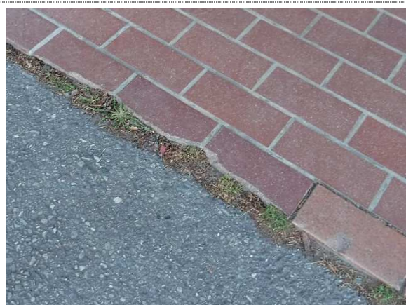
Bilde nr. 282-01 Brekkasje flis, slitte fuger v/innang
