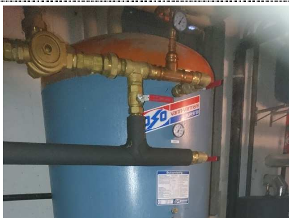
Bilde nr. 315-04 Eldre varmtvannsbereder
