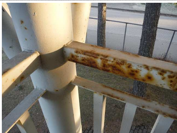
Bilde nr. 284-02 Korrosjon utvendig stål
