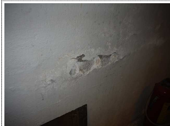
Bilde nr. 217-02 Fuktskader kjellervegg pga svikt drenering
