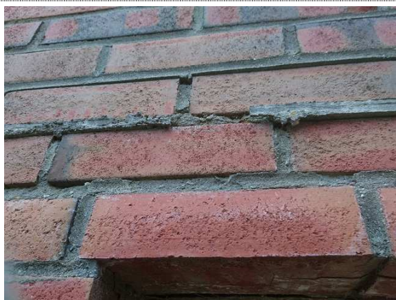
Bilde nr. 235-01 Løse fuger på teglfasade
