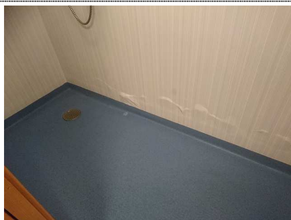
Bilde nr. 290-02 Tilfluktsrom/personalgarderober moden for renovering
