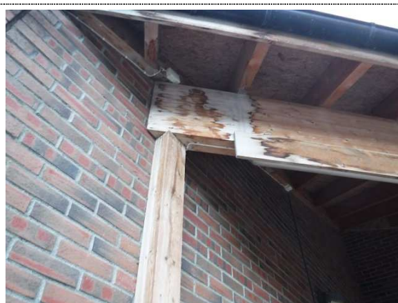
Bilde nr. 223-01 Fuktbelastning konstruksjon
