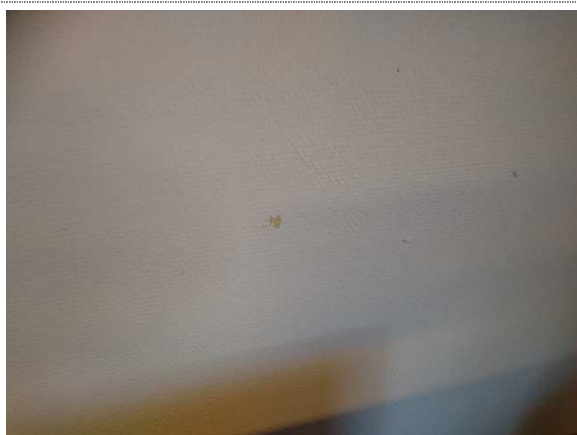
Bilde nr. 246-01 Bruksslitasje innervegger
