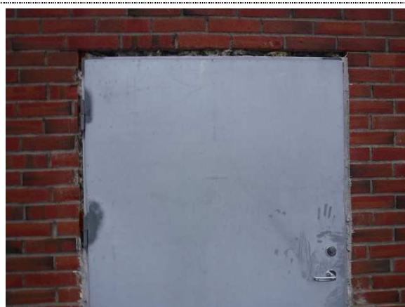
Bilde nr. 234-04 Ståldør ikke ferdig tett
