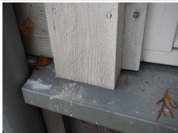
Bilde nr. 235-07 Kledningsbord uten klaring beslag; gir fuktsug og råte
