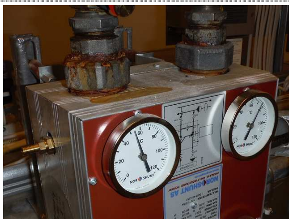
Bilde nr. 365-01 Lekkasje i shunt på ventilasjonsanlegg
