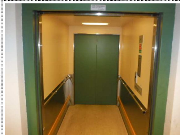
Bilde nr. 621-01 Heiser må renoveres/oppgraderes
