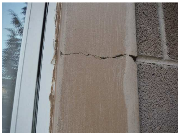
Bilde nr. 235-02 Sprekker i pusset omramming vinduer
