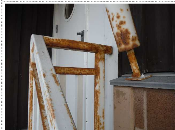
Bilde nr. 224-02 Korrosjon utvendig stål
