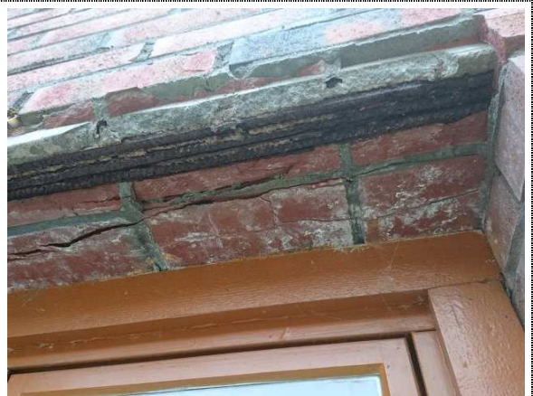
Bilde nr. 235-02 Omfattende skader, armeringskorrosjon og svikt bæring over vinduer
