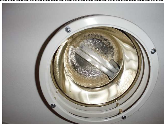
Bilde nr. 442-01 Lysarmaturer i fløy D: moden for utskifting
