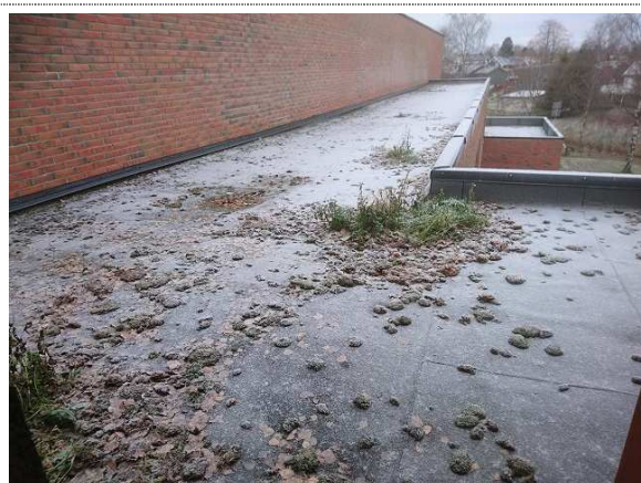
Bilde nr. 262-02 Omfattende mose, skitt, groing på papptekte tak
