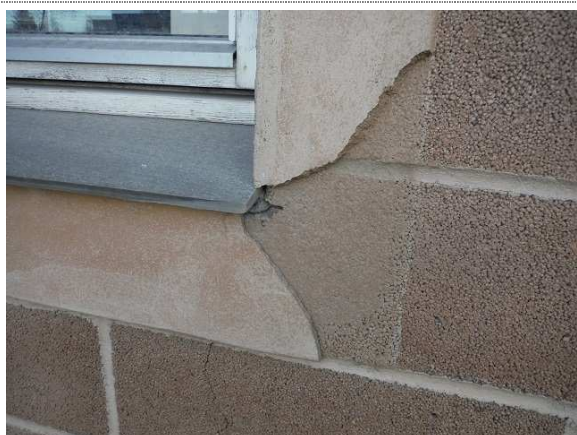
Bilde nr. 235-03 Avskallet puss
