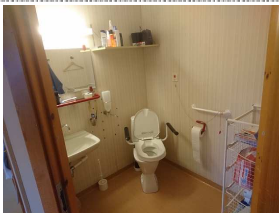
Bilde nr. 246-02 Bad beboerrom moden for renovering
