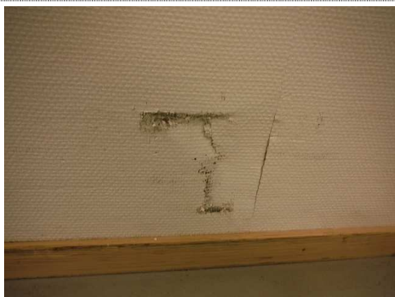
Bilde nr. 246-01 Innvendig bruksskade vegger
