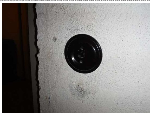
Bilde nr. 433-03 Fortsatt noe el-installasjon fra 1955
