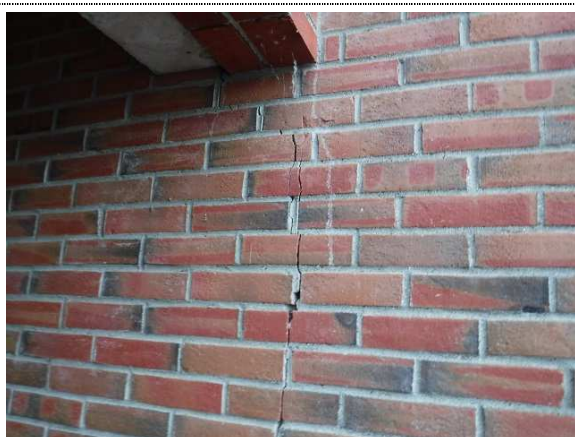
Bilde nr. 235-08 Sprekk i tegl v/konstruksjonsskille
