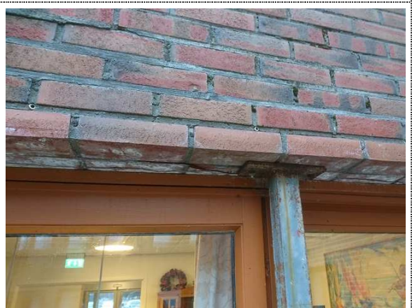
Bilde nr. 235-04 Teglkonstruksjon understøttet pga svikt
