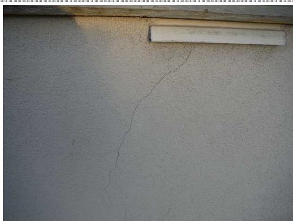
Bilde nr. 235-04 Sprekker/riss i pusset betongvegg
