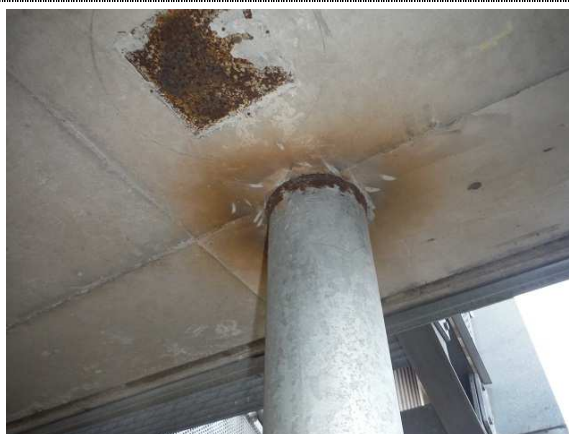
Bilde nr. 284-03 Korrosjon på galvanisert stålkonstruksjon fløy E
