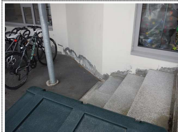
Bilde nr. 217-03 Fuktskader K-fløy
