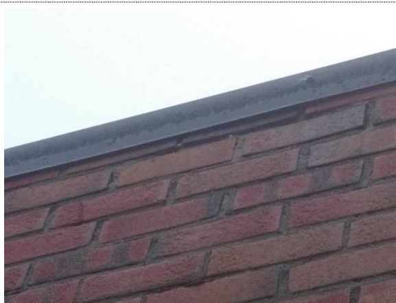
Bilde nr. 235-03 Forvitrede teglfuger pga utette beslag
