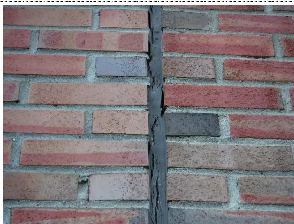
Bilde nr. 234-12 Bevegelsesfuge svært utett
