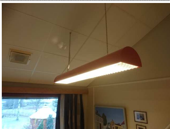
Bilde nr. 442-02 Lysarmaturer passert forventet levetid
