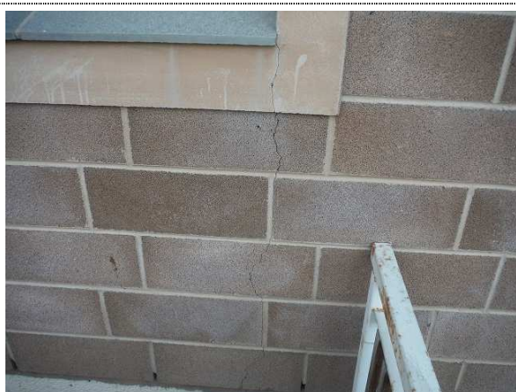
Bilde nr. 232-01 Sprekker i leca forblending
