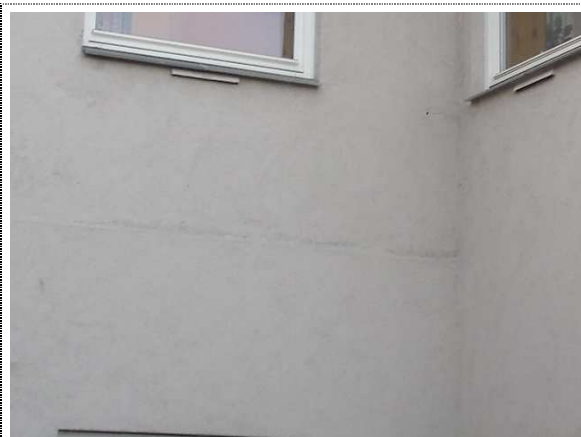
Bilde nr. 231-01 Symptomer fukt pga kuldebro i overgang dekke- yttervegg, fløy A
