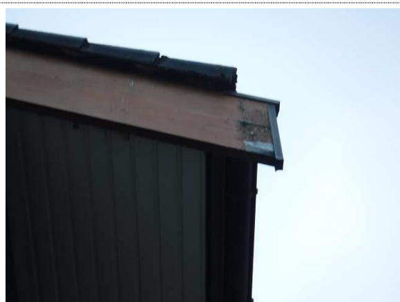
Bilde nr. 261-01 Fuktskader vindskier
