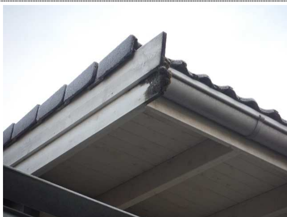
Bilde nr. 261-01 Råte vindskier
