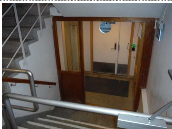
Bilde nr. 290-01 Inngangsparti/trapperom fløy A moden for totalrenovering
