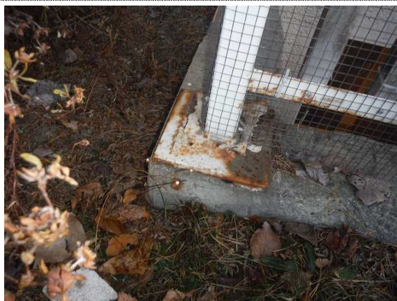
Bilde nr. 287-02 Korrosjonsskade i festeplate rekkverk lysgrav
