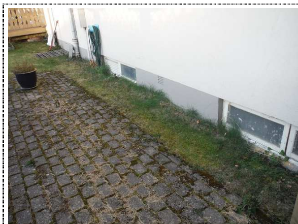
Bilde nr. 217-01 Manglende drenering/fall ut fra bygg
