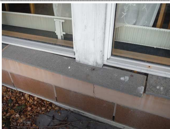
Bilde nr. 234-03 Sålbekk skifer-heller løs/utett
