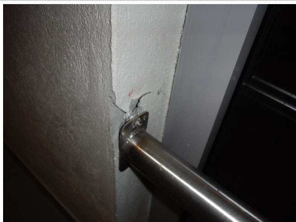
Bilde nr. 246-03 Løs innfesting beslag / skade puss
