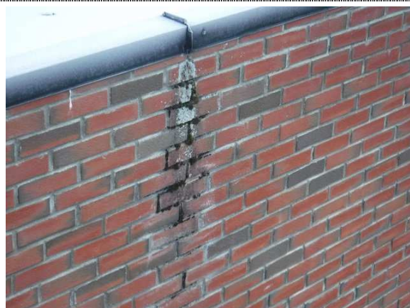
Bilde nr. 265-03 Fuktskader fasader pga utette gesimsbeslag
