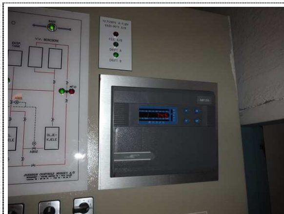
Bilde nr. 562-01 Delvis utdatert automatikk/undersentraler SD
