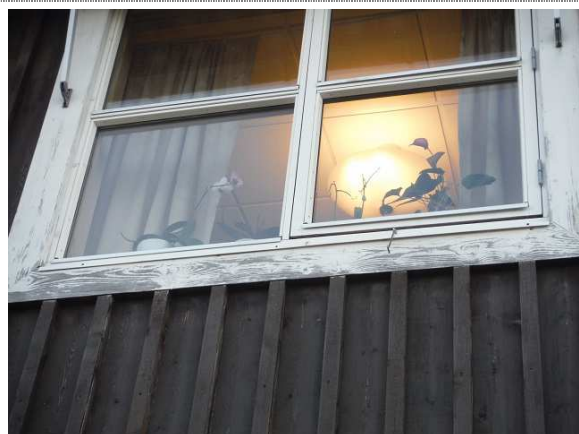
Bilde nr. 235-05 Behov utvendig overflatebehandling tre
